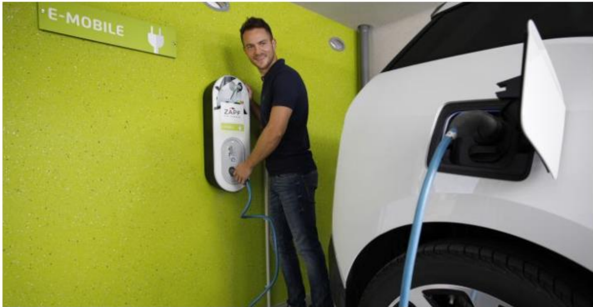
Verteilnetzbetreiber sollen künftig den Abruf flexibler Lasten nach hinten verlagern können. (Foto: Innogy SE)
